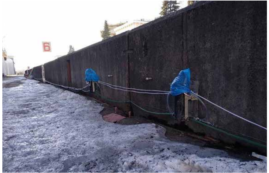
Рис. 8. Датчики гидростатического нивелирования системы «Монитор ДГН-2», установленные на правом берегу шлюза
